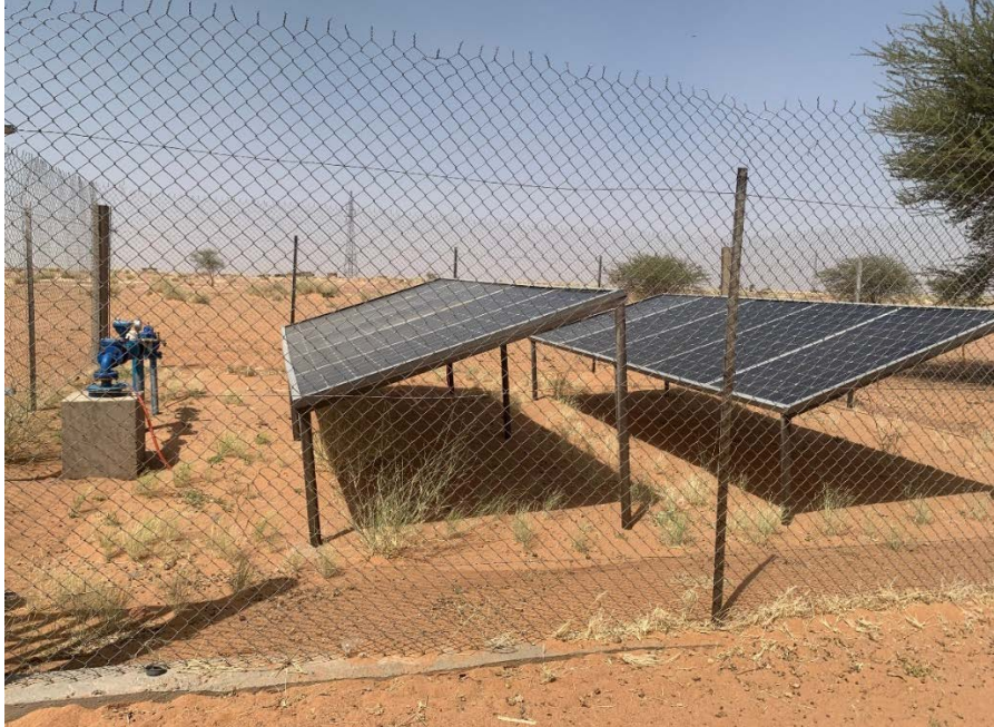
Une pompe à eau à énergie solaire près du projet Dasa.
