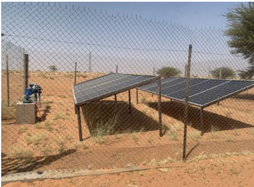
Figure 6-10: Pompe à eau solaire près du projet Dasa
